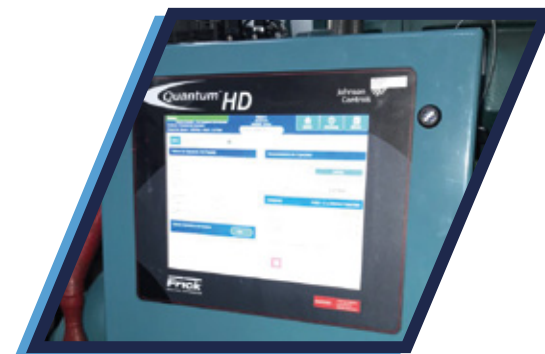
Instalación de controlador Quantum Hd.
