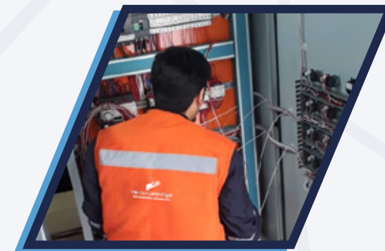
Diseño y armado de tableros de partidas de bombas.
