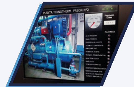
Sistema de alarmado en planta de frío teknotherm de freon.
