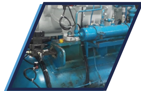
Instalación del sistema de control de planta de frío mycom.
