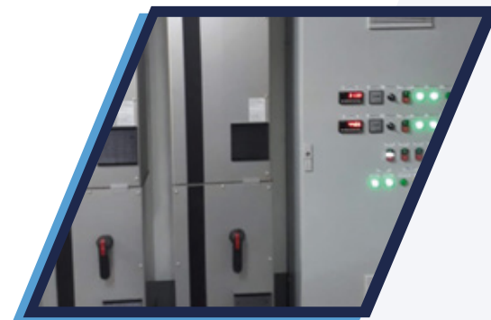
Modernización sistema de control plantas de frío con variadores de frecuencia danfoss.
